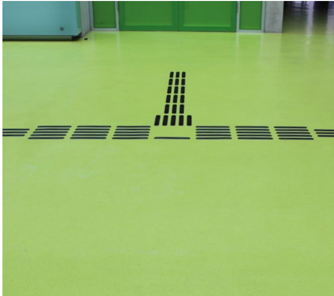
Abzweigfelder zum Aufzug
